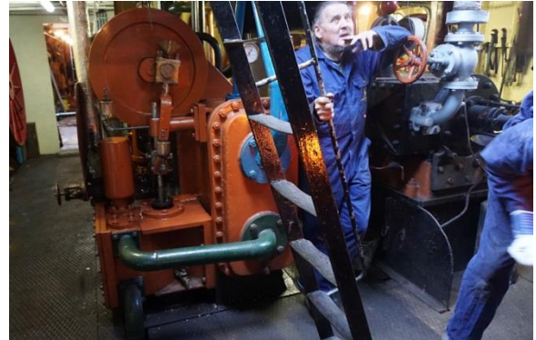
Etienne staat bij de trap naar het dek. Links van hem de condensor met de koelwaterpomp en de luchtpomp.
